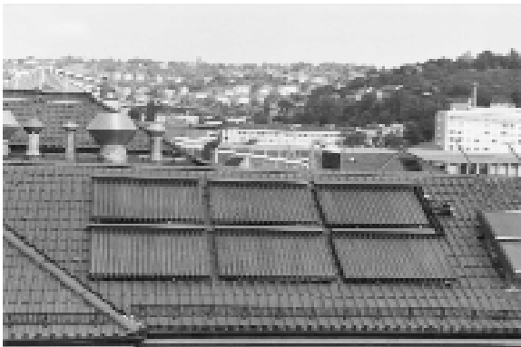
Abb. 3: Solaranlage auf dem Dach der HfT Stuttgart. Foto: Dipl.-Ing.(FH) Uli Jakob
